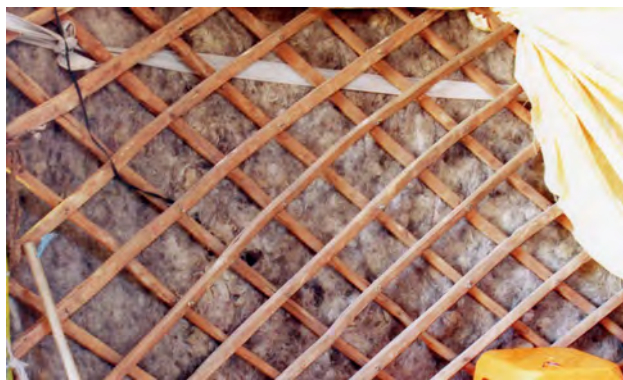
外張りのフェルトとハン 右上の白布は内張り
