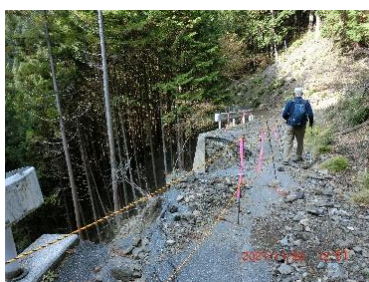
破損した舗装道
