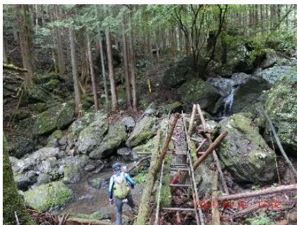
白滝沢（猪鼻沢？）の破損した橋
